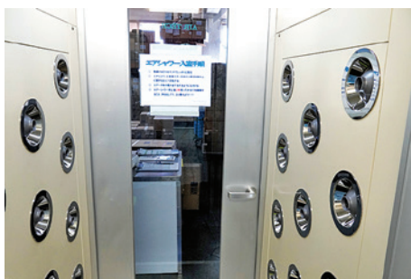
エアシャワー室
